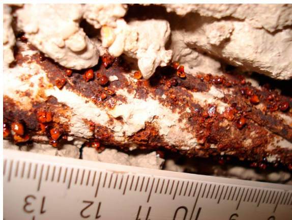
Bild 9. Korrosion an einem Längsreifen der Rippendecke
