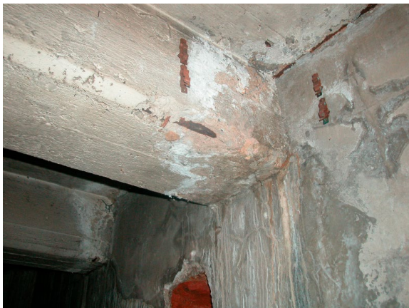
Bild 2a. Feuchte- und Korrosionsschaden an einem UZ
