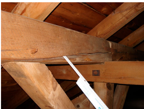
Bild 3a. Rissbildung an einer Mittelpfette
