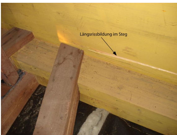
Bild 3b. Rissbildung in einem Holzträger
