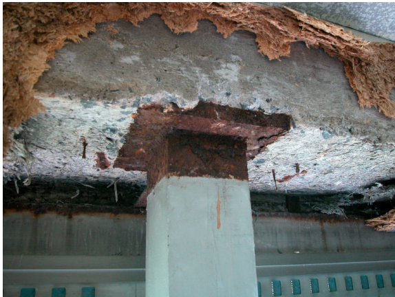
Bild 1a. Stahlstütze mit Rostschaden am Stützenkopf
