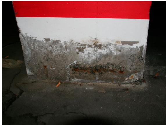
Bild 2b. Schäden an Stützen in einer Tiefgarage
