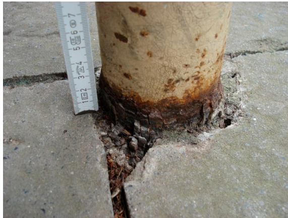
Bild 1b. Stahlstütze mit Rostschaden am Stützenfuß
