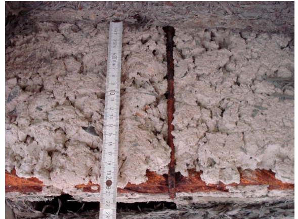
Bild 8. Freigelegte Rippe mit poröser Betonstruktur ohne Betonfeinanteile
